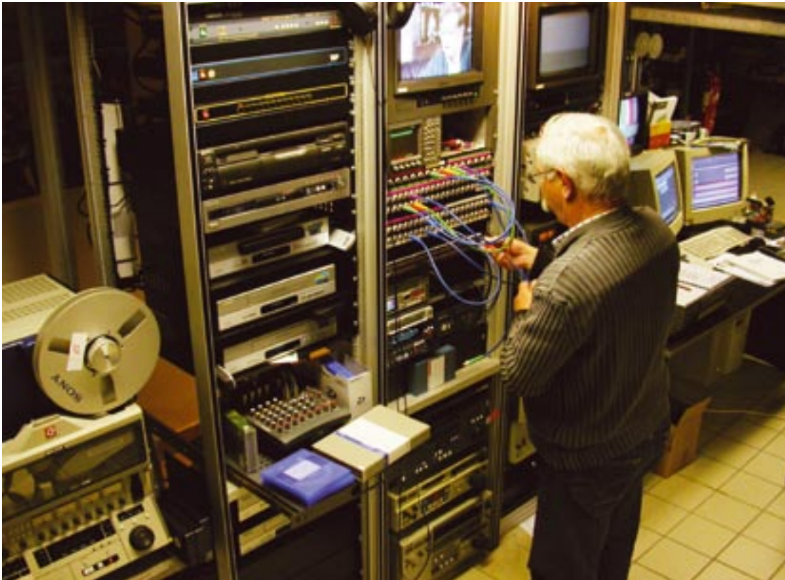
NODAL installé par la société IEC /ASV
